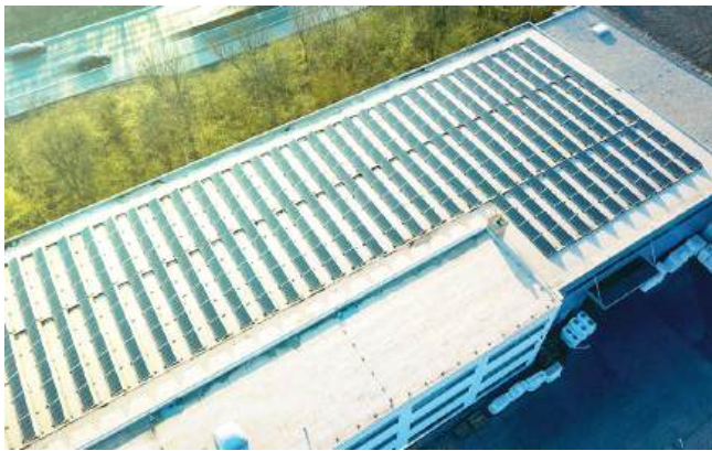
Ökostrom von modernen Sonnenkollektoren auf dem Dach des Firmengebäudes.
